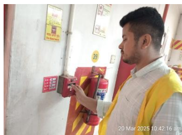
Fire alarm tested.jpg
