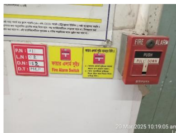
Fire alarm switch.jpg
