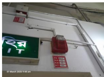
Fire alarm sounder.jpg
